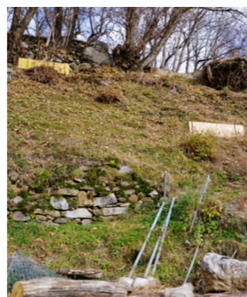
Vorher: Beschädigte Trockenmauern, umgestürzte Bäume
