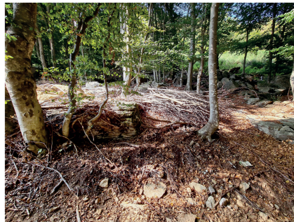
Aufräumarbeiten in einem Waldstück nach dem Unwetter
